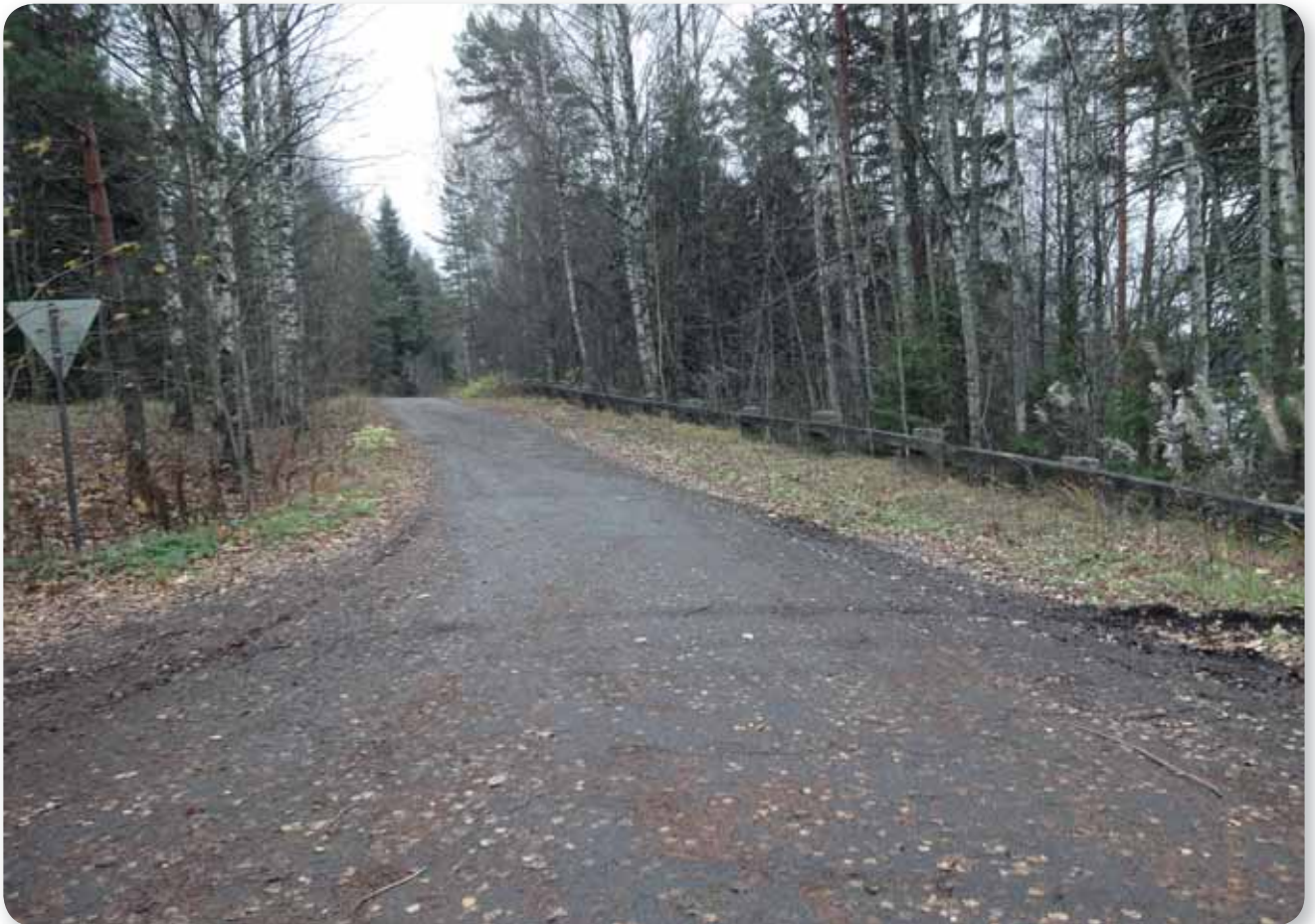
Kuva 25. Savukoskentie on suunnilleen 1950-luvun tieremonttia vastaavassa kunnossa, tosin rappeutuneena. Tielinja noudattaa Savukosken sillan yhteydessä rakennettua tieoikaisua, joka peittää alleen vanhan Suuren Rantatien. Tien kivikaitteet puujohteineen on rakennettu Strömforsin ruukin tehdasradan ylikulkusillalle. Toivottavasti maanomistaja avaa risukoituneen näkymän patojärvelle. Kuva Martti Piltz.
