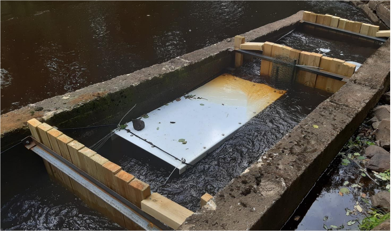
Kuva 4. Siikajoen Pöyryn eteläisen pystyrakokalatien kameratunneli asennettuna.
