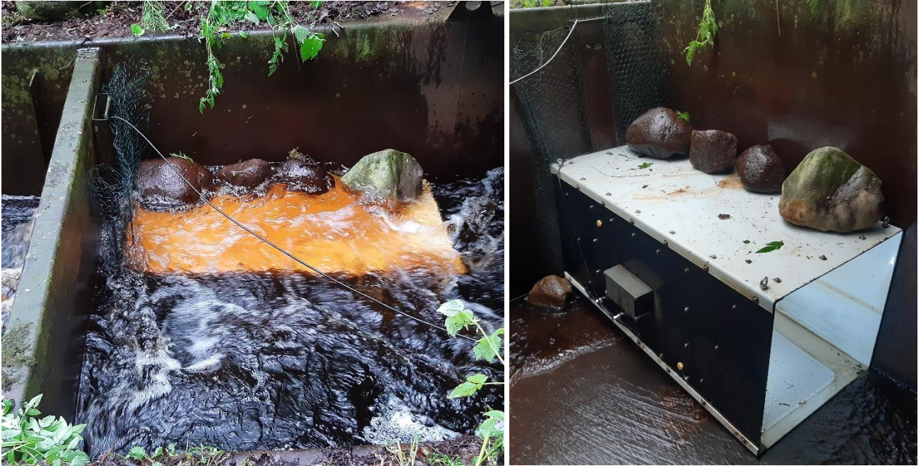
Kuva 6. Piehinkijoen Kettulankosken pystyrakokalatien kameratunneli asennettuna.
