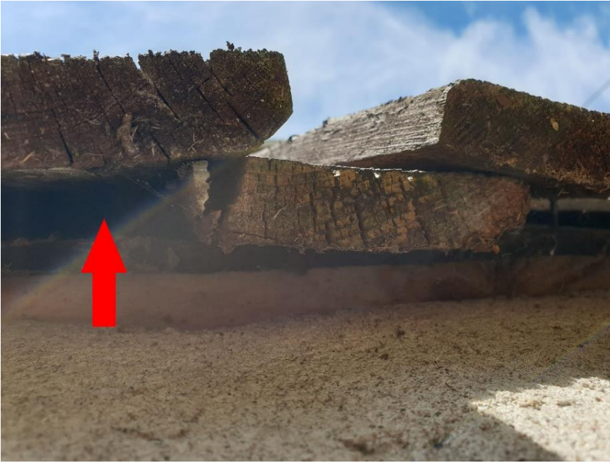
Kuva 2. Koko ongelman ydin on seinälaudoituksen rakenne, joka on lepakoille erittäin houkutteleva. Eri tasossa oleva laudoitus jättää ulompien lautojen taakse raon, joka on lepakoille erinomainen oleskelutila. Kuva otettu alhaalta ja tila osoitettu nuolella. Tällä kohteella rakoja oli tukittu metalliverkolla, ilmeisesti onnistumatta estämään lepakoiden kulkua. (Kuva ei ole tältä kohteelta, vaan vastaavasta rakenteesta muualta. Rakenne on hyvin yleinen vanhemmissa taloissa.)
