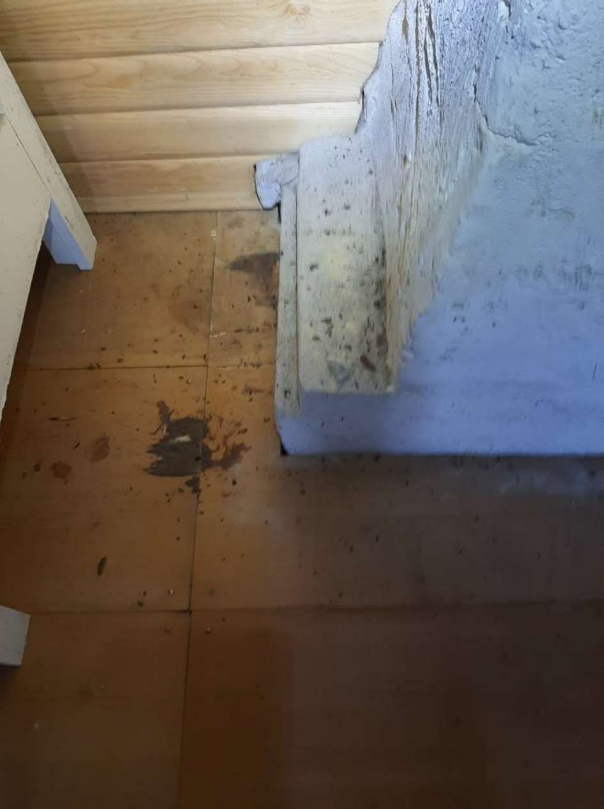
Kuva 4. Lepakon ulosteita vinttihuoneessa muurin tyvellä.
